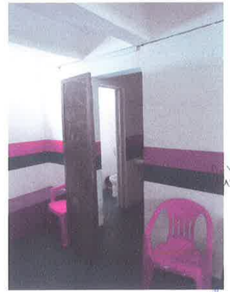
Banheiro masculino. Improvisação com tapume de madeira para minimizar a falta de privacidade.
