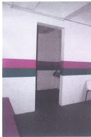
Banheiro masculino. Localizado junto à sala de descanso. Falta de privacidade aos policiais.
