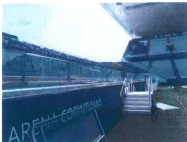
Foto 09: Guarda corpo da arquibancada
