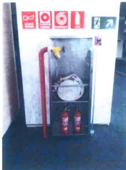
Foto 03: hidrante com equipamentos de segurança
