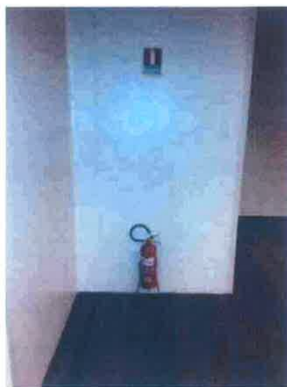
Foto 02: Extintor de PQS
