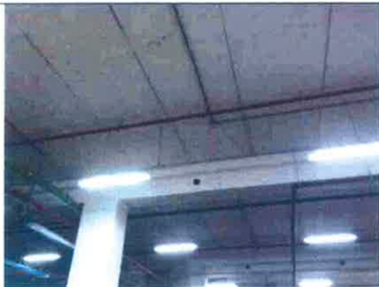
Foto 04: Sprinkler no estacionamento
