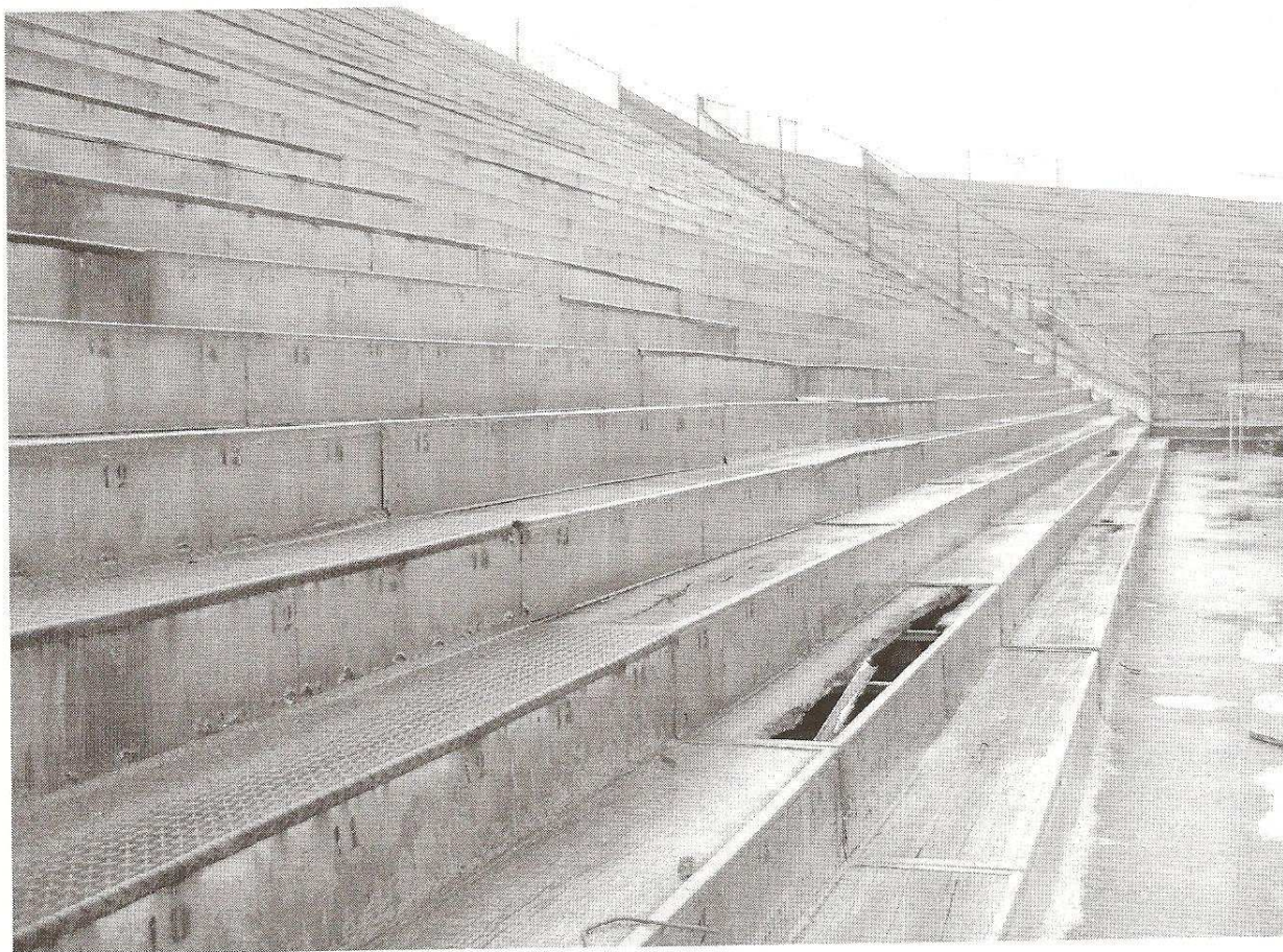
Foto 1: Arquibancadas do setores 3 a 6 (bloco V) - INTERDITADA
